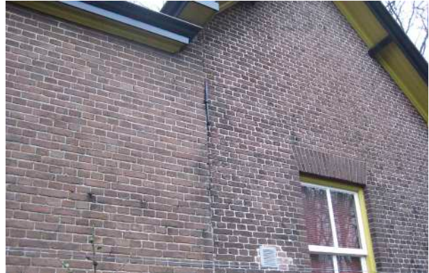
In de achtergevel is het verschil in ouderdom tussen de remise (rechts) en het nieuwere deel (links) goed af te lezen.
